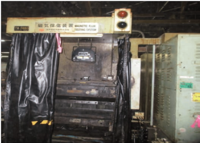
改造前磁気探傷装置
